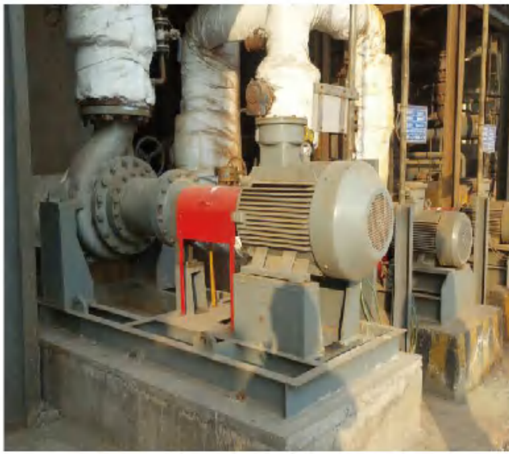
甲烷氯化物装置 氯甲烷输送泵 Pump for Methyl chloride in Methane chlorides Unit 流量Q : 400m 3 /h 扬程H : 20m 温度Temp : 180°C
