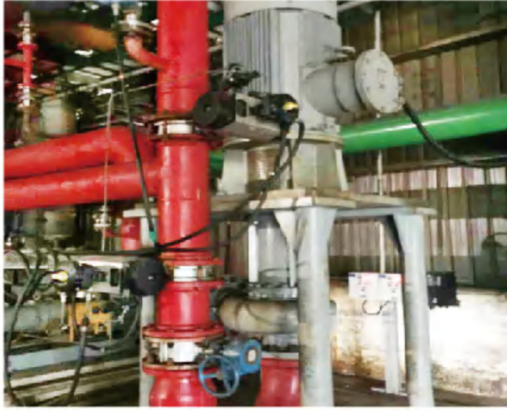
四氯化钛原料泵 Pump for TiCl_4 raw material 流量Q : 450m 3 /h 扬程H : 40m
