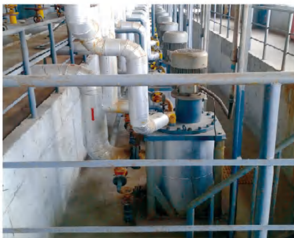
烧碱项目 液氯输送泵 Pump for Liquid chlorine in Caustic soda project 产能 : 60万吨/年 Capacity : 600kt/a
