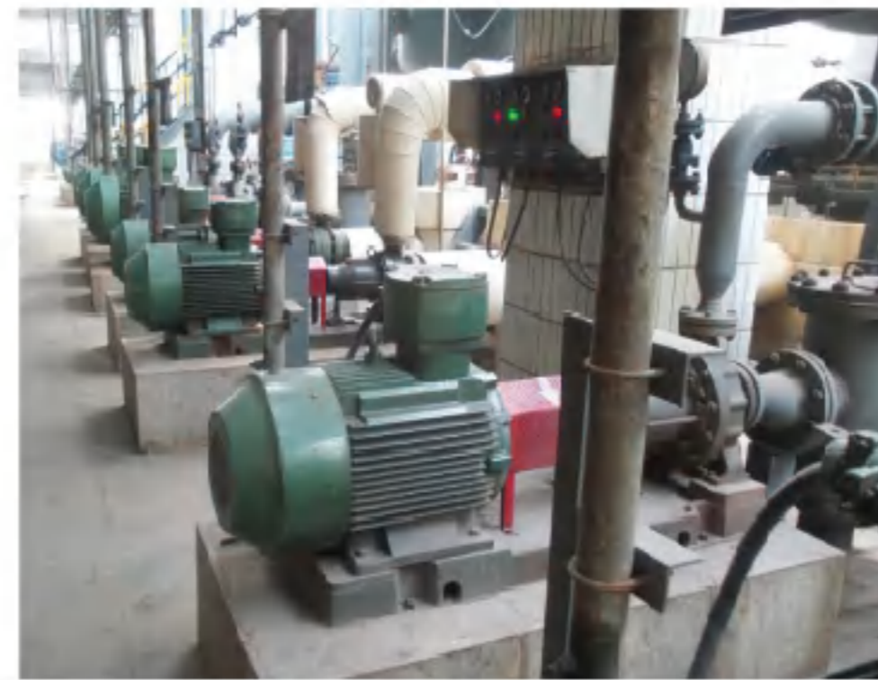
甲烷氯化物 Methane chloride 产能 : 8万吨/年 Capacity : 80kt/a
